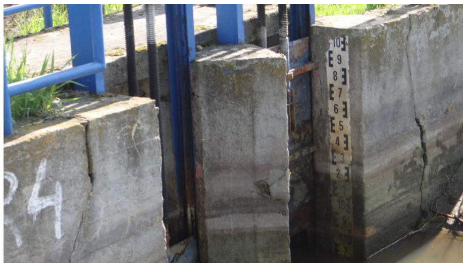
Zastawka R4 - stan dolny E7
