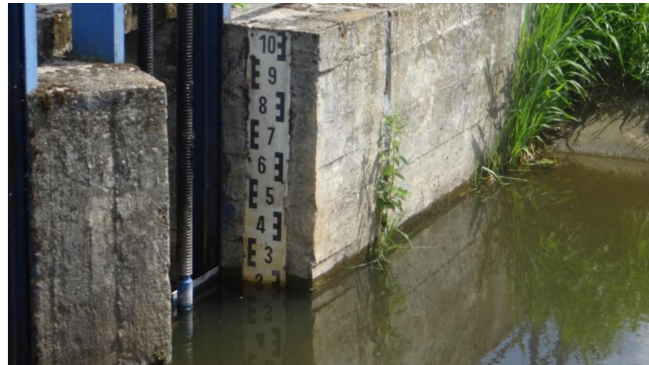
Zastawka R5 - stan górny E2
